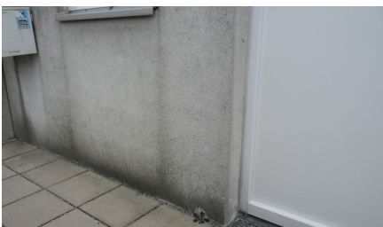
Schadhafter Anschluss an Traufenbelag
