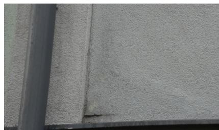
Schadhafter Anschluss an Verblechungen
