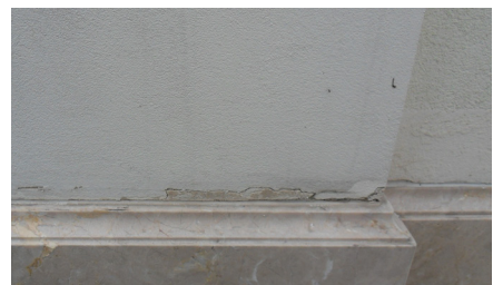
Schadhafter Anschluss an fremde Bauteile und Sockel
