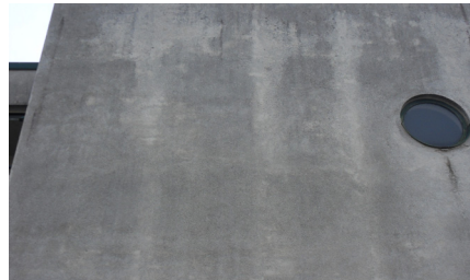
Algenbefall und Verschmutzung
